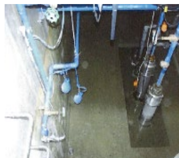
▲地下に設けられた雨水槽
