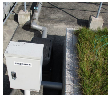
▲植栽の維持のために設置された自動灌水装置
